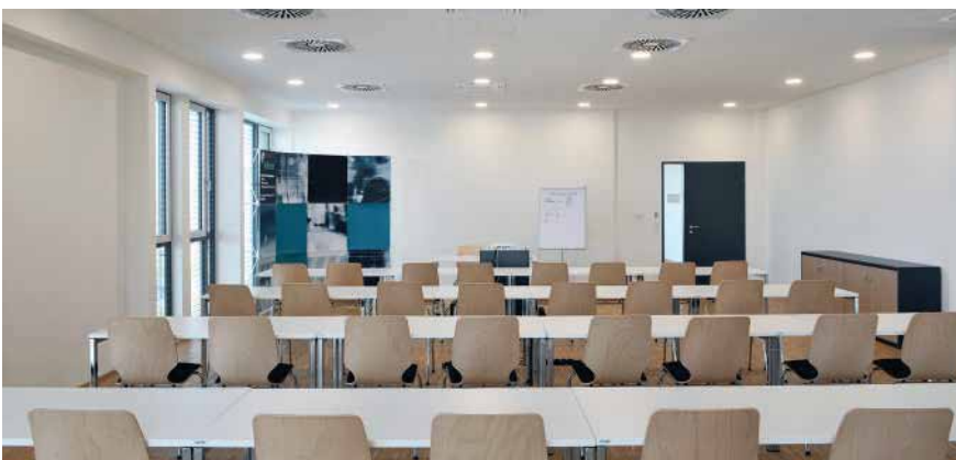
Вътрешните телъ в офис помещенията и злите заседания се регулират индивидуално посредством модерни, персонализирани сензорни екрани с пълноцветен дисплей, които могат да се конфигурират и обслужват чрез смартфон с Bluetooth.
